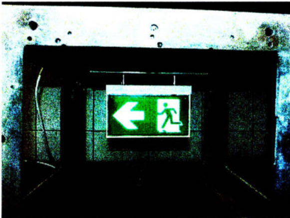
Bild 9 Ceruna (Rettungszeichen und Sicherheitsleuchte) während der Funktionsprüfung nach der Spritzwasserschutzprüfung IPX4
